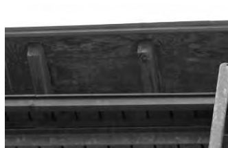
Abb. 60: Schaden durch Verwendung von nicht geeigneten Material
