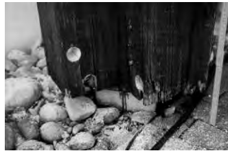
Abb. 56: Schaden durch nicht normgerechten Einbau des Stützenfußes
