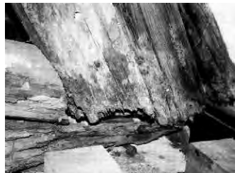
Abb. 58: Schaden durch nicht fachgerecht ausgeführte Dachkonstruktion
