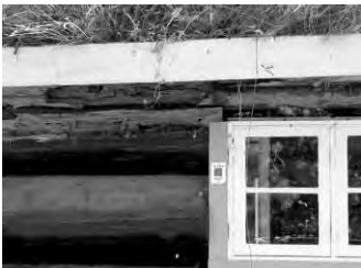
Abb. 57: Schaden durch nicht fachgerecht ausgeführte Dachkonstruktion
