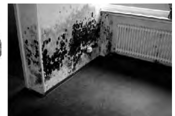
Abb. 30: Befall durch Schimmelpilze
