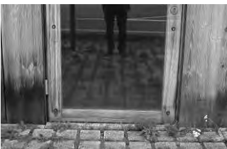
Abb. 59: Schaden durch nicht fachgerecht ausgeführte Wandkonstruktion
