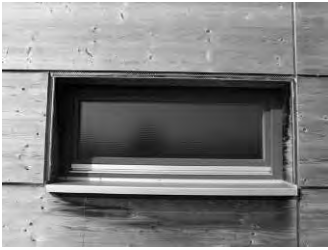
Abb. 53: Unregelmäßigkeit in der Verwitterung
