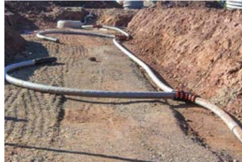
Nahwärmeversorgung Kohlstätter Hardt Freudenstadt © Foto: Stadtwerke Freudenstadt
