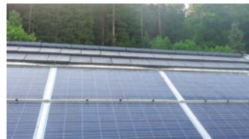
Wohnhaus Ruf, 5kW Fotovoltaik-Anlage inkl. Stromspeicherung, S. 39, © Foto: Zimmerei Schleh
