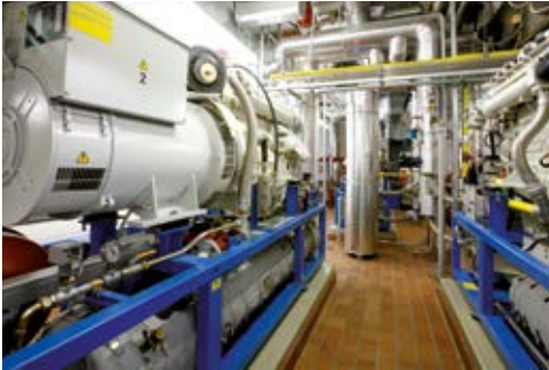
Blockheizkraftwerk © Foto: Stadtwerke Freudenstadt
